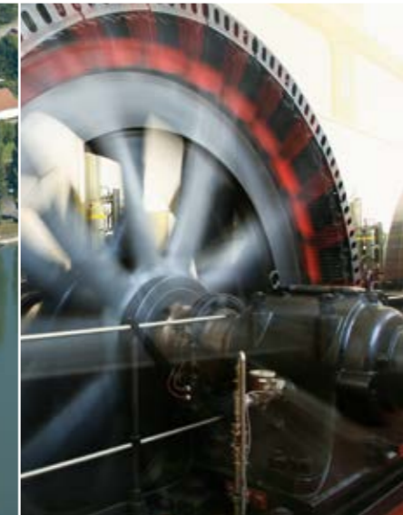
Generator einer alten Francis-Maschine
