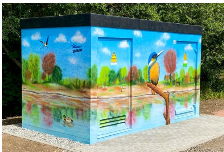
Pflanzen und Tiere schmücken die Trafostation in Donaueschingen.
