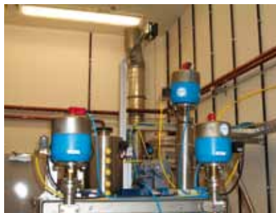
Abbildung 12: Experiment mit pneumatischen Ventilen und darüber installiertem Gassensor
