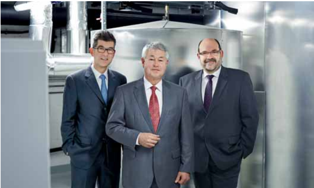
Martin Steiger, Hans Kuntzemüller und Michel Schwery (von links) im Technikraum des DGNB-zertifizierten Büro- hauses in Rheinfelden.
